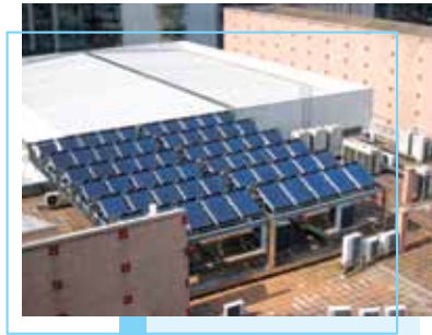
(Figura 7) Fotografia do sistema de aquecimento de água a energia solar na piscina Tamagnini Barbosa.
